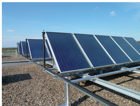
Solární systém na bytovém domě Praha
