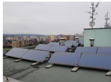
Solární systém na bytovém domě Tábor
