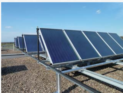
Solární systém na bytovém domě v Praze
